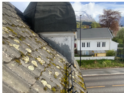
Råteskader på listverk på tårn
