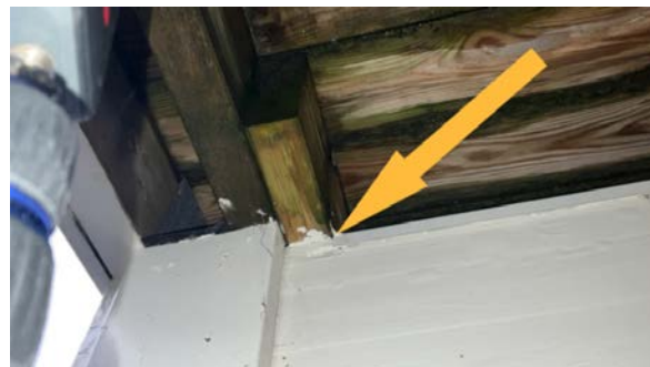
Tegn til råte i drager
