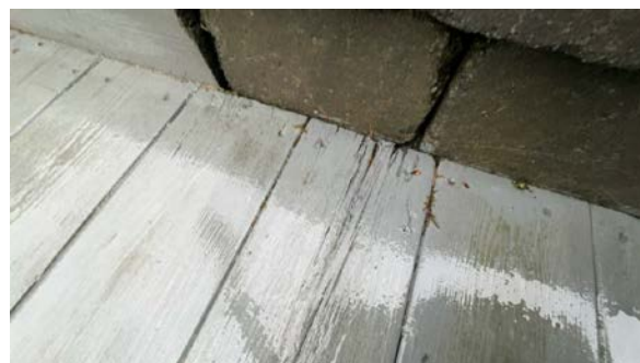
Råte i terrassebord.
