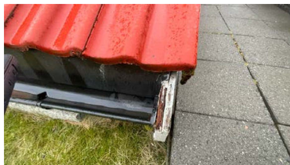
Råte på vindskibord
