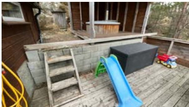
Forstøtningsmur i forskalingsblokk uten rekkverk på topp.
