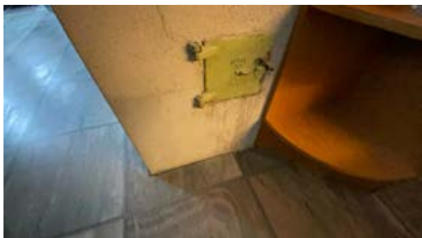
Brennbart materiale nærmere enn 30 cm fra sotluke. på siden og under mot gulv.
