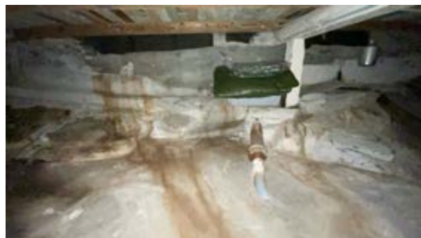
Visuelt innsig av vann mellom grunnmur/grunnfjell i krypkjeller under soverom i 2. Etasje.
