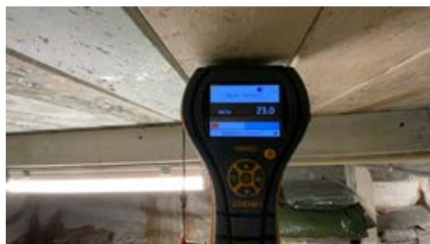
Det ble målt 23 vekt% fukt opp under bjelkelag ved dagens befaring.
