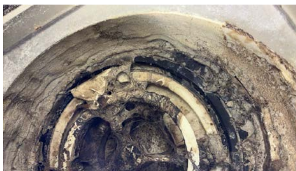
sluk under dusjkabinett
