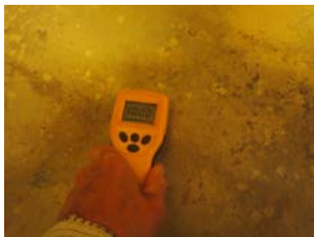
Det indikeres mye fukt i gulvene
