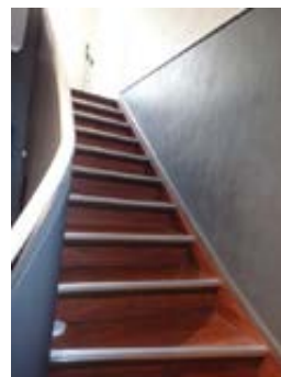
Trapp mellom 1.etg og 2.etg. Ikke håndlist
