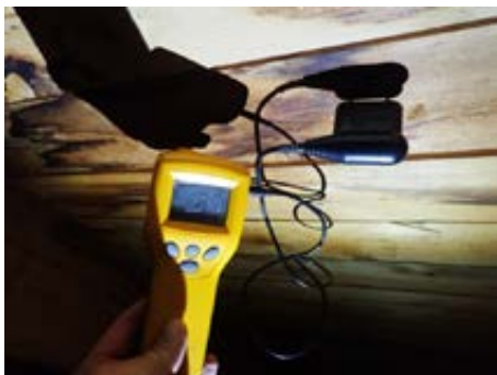
Ca 8 % fukt i trobordene - betegnes som tørt
