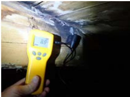
Fuktskadede sperre - Ca. 9% fukt - betegnes som tørt
