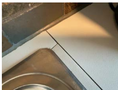
Mindre svellskader i benkeplate ved oppvaskkum.
