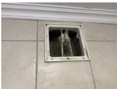
Defekt deksel på klaffventil.
