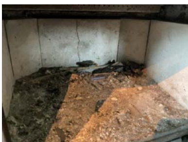
Spekk i ildfast stein, må påregnes skiftet.
