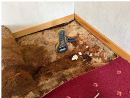
Store fuktskader i gulvet i stuen i underetasje.
