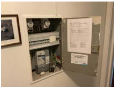
Sikringskap plassert i fglles gang/trappeareal.
