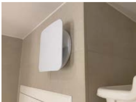
Elektrisk avtrekksvifte på vegg.
