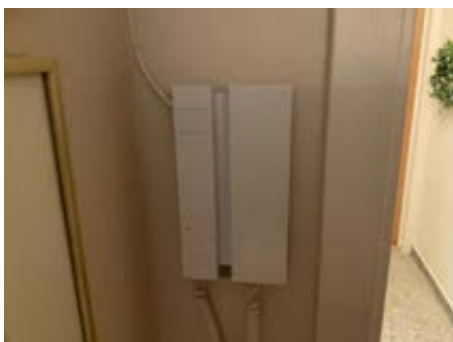
Dørklokke med kommunikasjon/åpningsmulighet av felles yttersdør.
