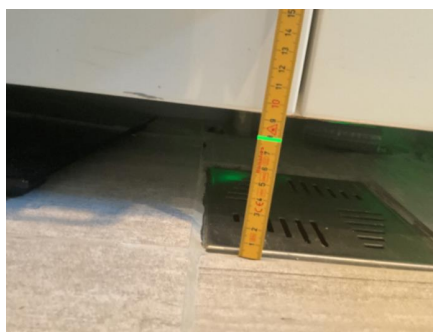
Høydeforskjell (ved sluk)
