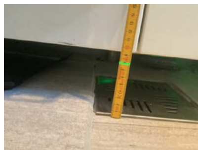
Høydeforskjell (ved sluk)
