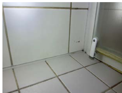
Skade på flis i vegg i dusj-sone.
