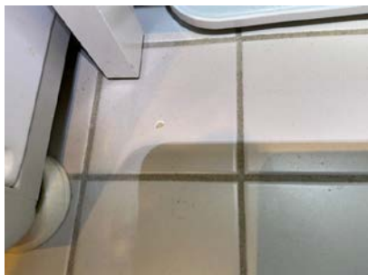
Skade på flis på gulv ved vaskemaskin.
