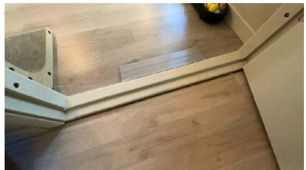
Synlige avvik på gulv.
