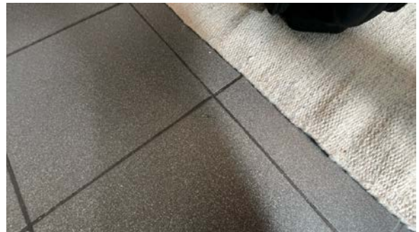
Synlige avvik på gulv.
