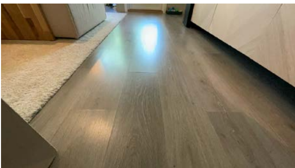
Synlige avvik på gulv.
