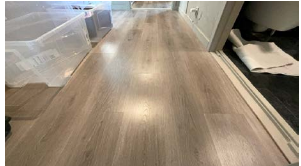
Synlige avvik på gulv.
