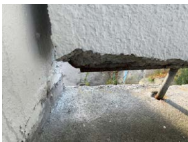
Rustsprenging og noe løs betong på rekkverket.
