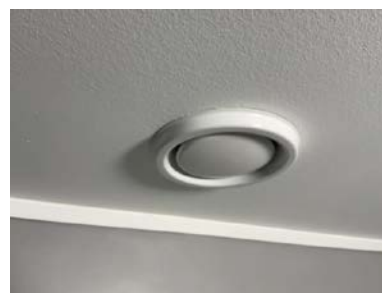
Avtrekksventil i himlingen
