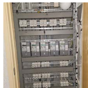
Sikringsskap med skrusikringer
