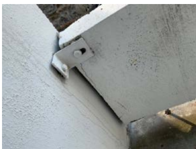
Sprekker i rekkverkelement
