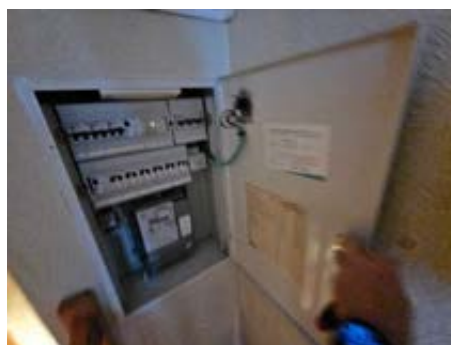
Skap plassert i 2 etasje.
