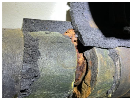
Rust/korrosjon på vannrør.
