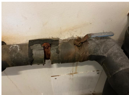
Rust/korrosjon på vannkran.
