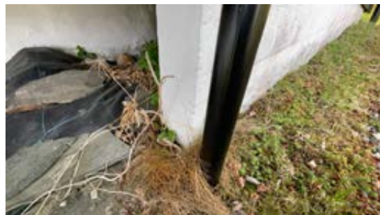
Sprekker i ringmur på tilbygg
