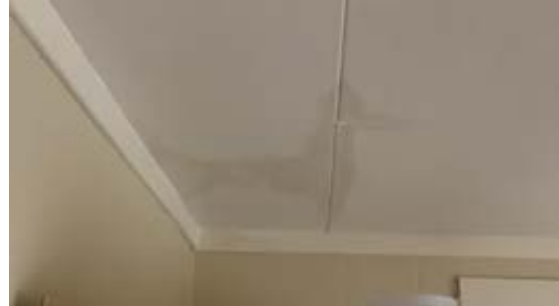
Fuktmerker i himling inne på soverom 3 ved pipe.
