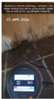
Kontroll av innført yttervegg i verksted hvor det er synlig skade i panel. Det er målt 20,5% og forhøyde fuktavvik.
