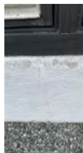
Sprekker i puss/overflate foran vindu i front
