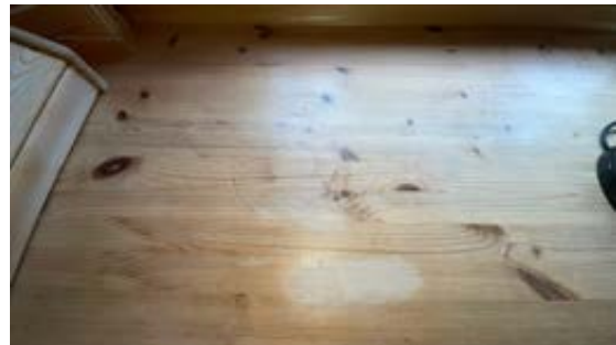
Slitasje og merker er observert på den lakkede benkeplaten av heltre.
