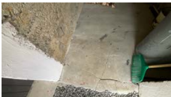
Sprekker i betonggulv ved kjellerinngang og lagerrom
