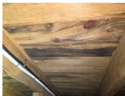
Det er påvist fuktskjolder og misfarging i takkonstruksjonen
