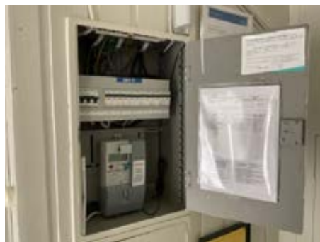
Sikringsskap plassert felles gang/trapperom.
