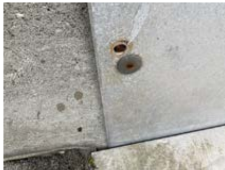
Luke skrudd igjen med korroderte skruer, ikke tilkomst.
