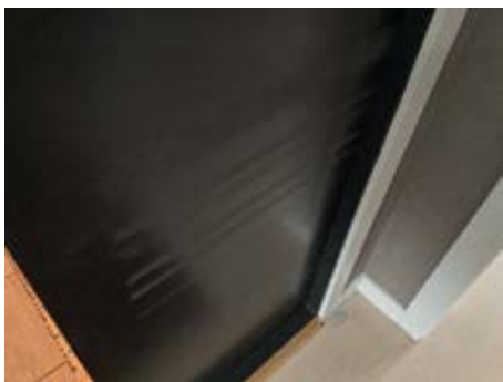
Skade på skyvedør, må påregnes justert/malt på ny.
