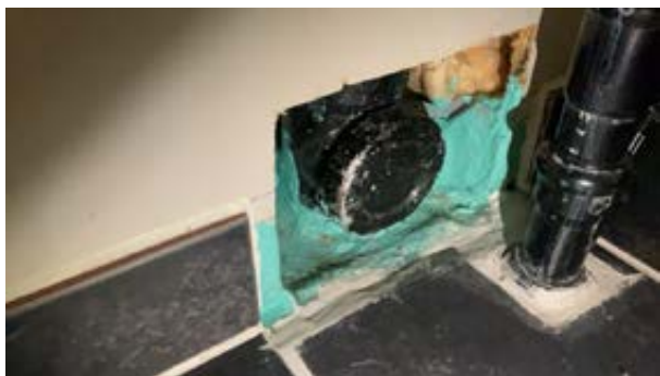
Stakepunkt i vegg på vaskerommet.
