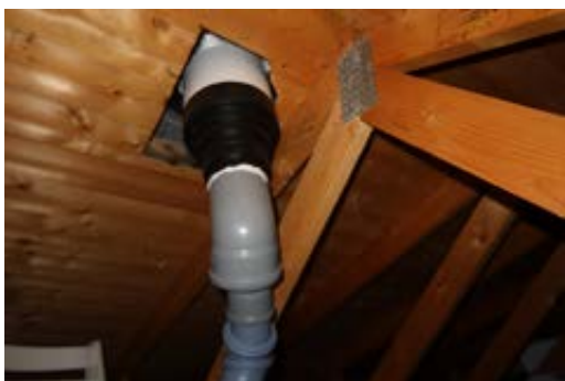
Lufting kloakk over tak.
