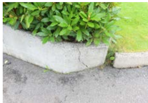
Forstøtningsmur med setningsskade
