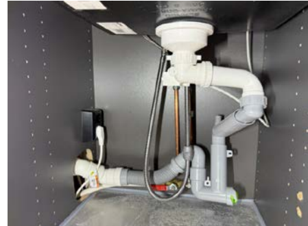
Stoppekran i kjøkkenbenk
