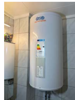
Bereder på baderomsvegg fra 2019
