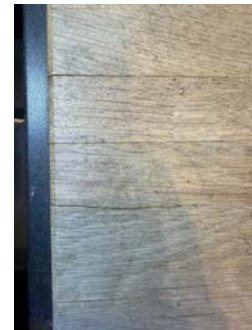
Småsprekker i benkeplate ved kum
