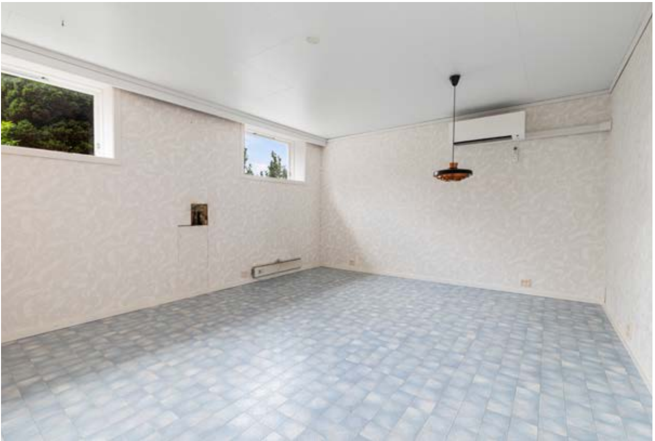
Det er satt inn ny varmepumpe i rommet
