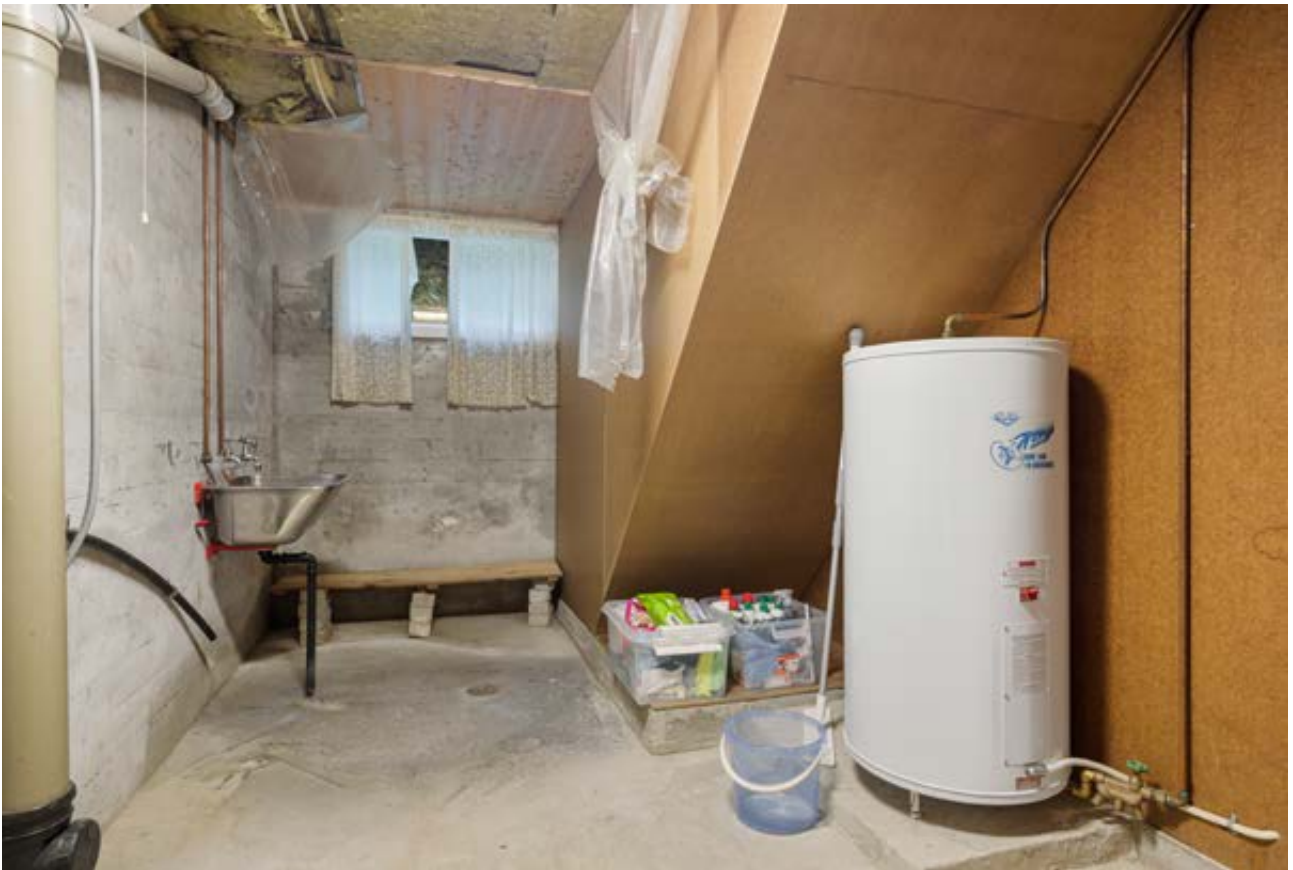
Bod med sluk og utslagsvask
