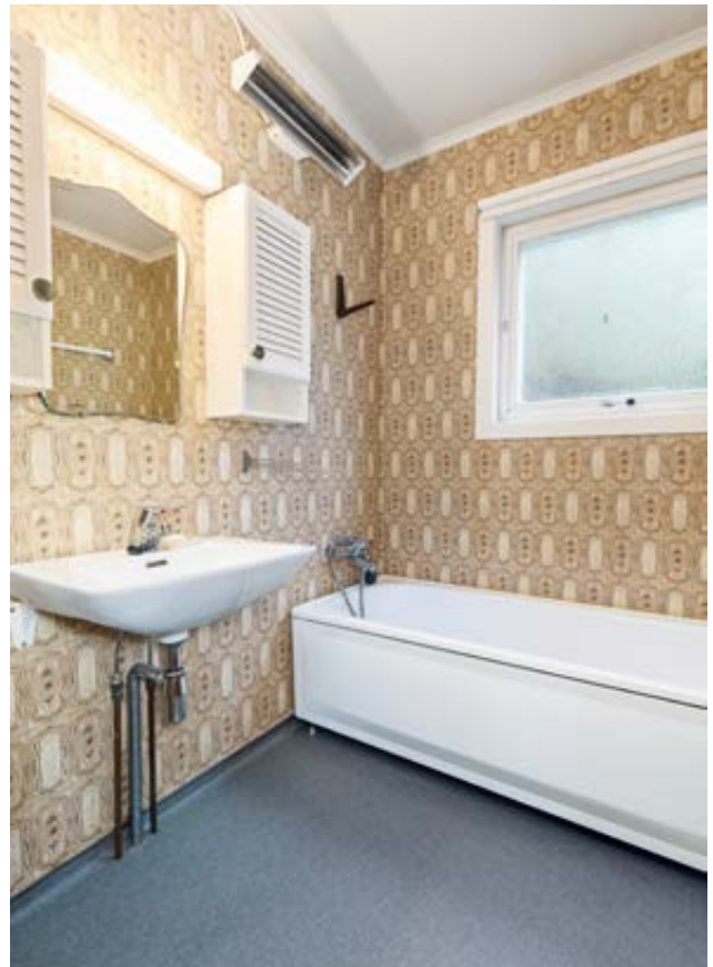
Bad med servant og badekar, krever renovering
