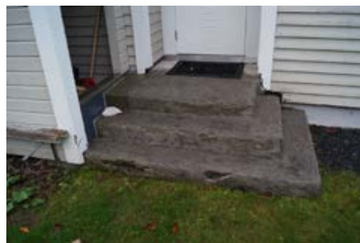
Betongtrapp har mindre sprekker/skader
