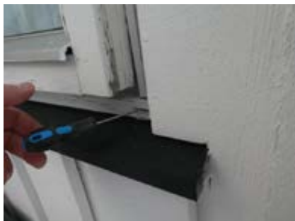
Vinduskarmer utvendig slitt
