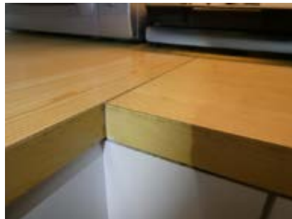
Liten avvik i skjøte på benkeplate
