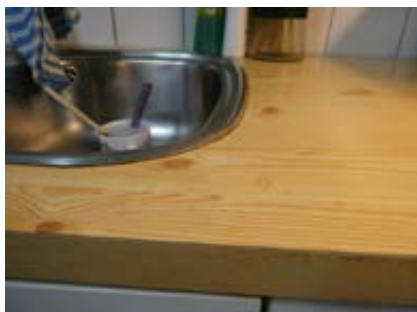
Svertesopp mellom benkeplate og beslag
