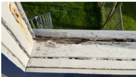
Råteskade vindu levegg
