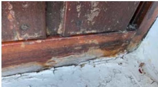
Råte nedre del hoveddør
