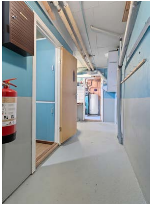
Gang, med teknisk rom i enden som inneholder varmtvannstank på ca 200 liter
