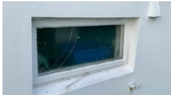
Underetasje: Knust glass, uten beslag underkant
