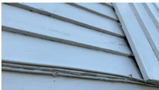
Ved tun - værslitasje
