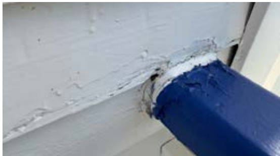
Værslitasje, råte ved overgang til vegg.
