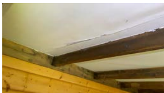
Tak kjellerstue, revna takduk
