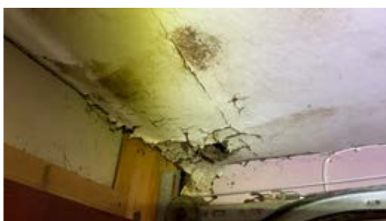
Fuktskade garasje nord, tørt befaringsdagen
