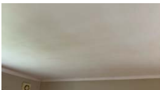
Stue, himling ved spisstue, misfarging
