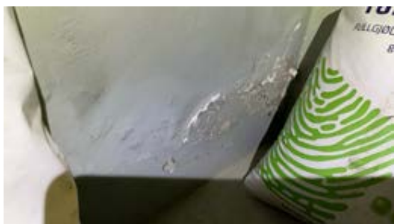
Tegn til noe fuktinntrengning
