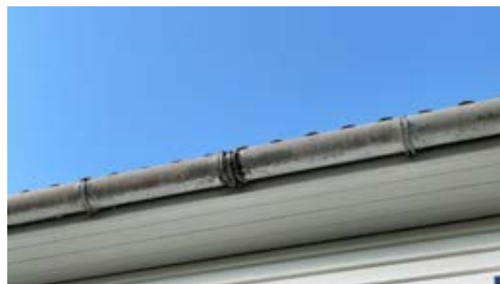
Tegn til utetthet i takrenneskjøt
