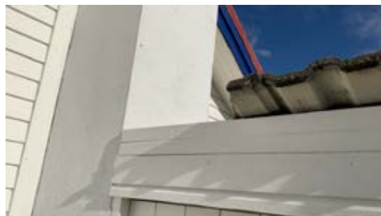
Parti med manglende takteking over levegg
