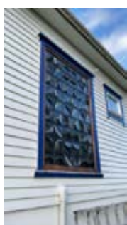
Tegn til at det har vært fuga mellom glassbyggestein
