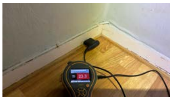
Målt 23% i fuktkvoteprosent i gulvlist under trapp
