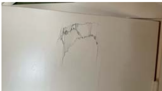
Skada dørblad soverom sør loft
