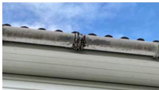
Tegn til lekkasje fra takrenne, parti av konstruksjonene ved/under med risiko for fuktskade
