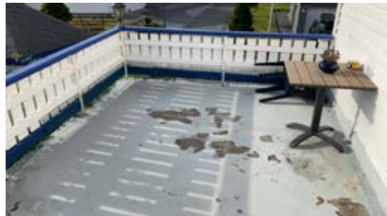
Avskalla betong, oversikt
