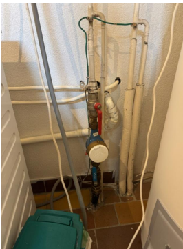
Inntaksrør med hovedstoppekran på vaskerommet nede.
