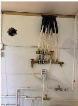
Samlestokker montert på vegg i vaskerom.
