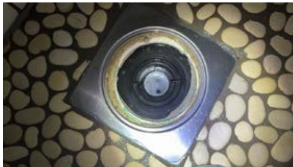
Sluk bad i underetasje
