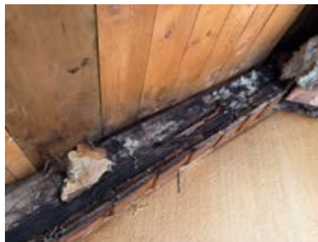
Råte i takspærre.
