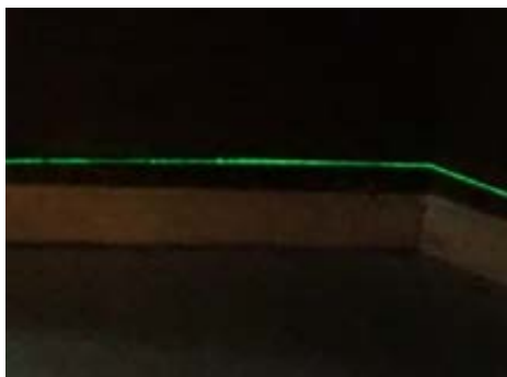
Høyre hjørne med avvik på ca 35 mm
