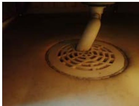
Sluk under dusjkabinett
