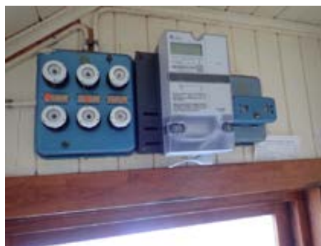
El-anlegg på vegg på loft.
