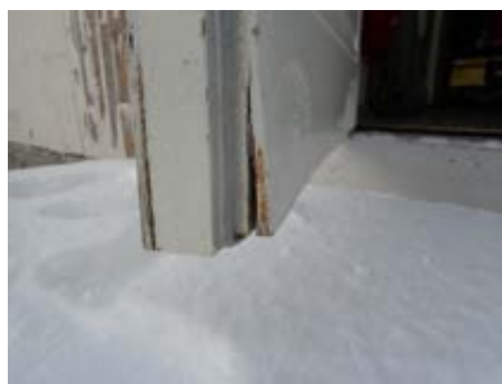
Skade i hovedinngangsdør
