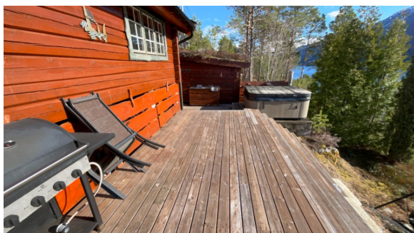
Det er ikke montert rekkverk ved spabad
