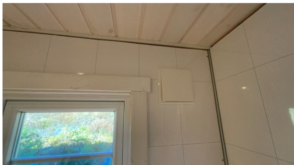
spjeldventil på yttervegg.
