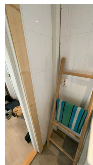
Ikke fagmessig utførelse av baderomsplate.
