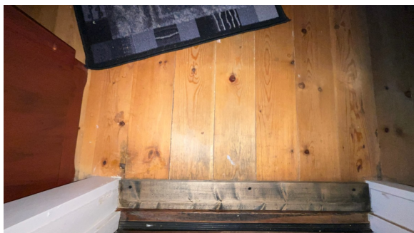
Misfarget gulv ved døråpning
