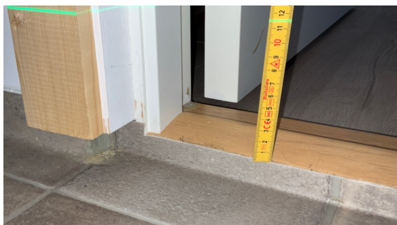
Ikke fagmessig utførelse av oppbrett på gulvbelegg.
