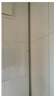
Ikke fagmessig utførelse av baderomsplate.
