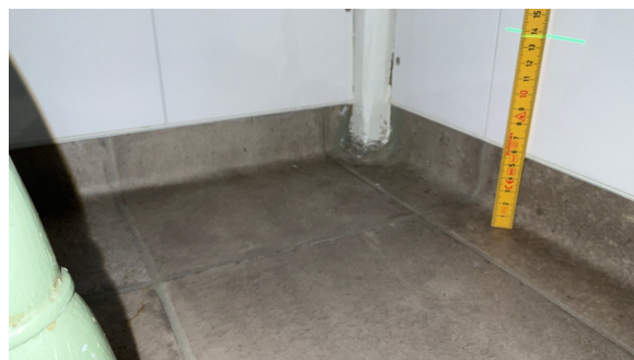
Ikke fagmessig utførelse av oppbrett på gulvbelegg.
