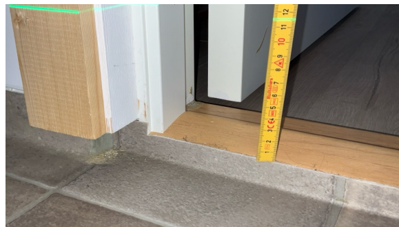
Høyde oppbrett gulvbelegg. 23mm over sluk.
