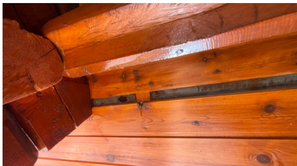
Skadet insektsnetting i raftekaske.
