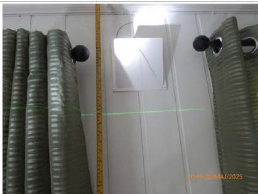
Ettermontert ventil i stue.
