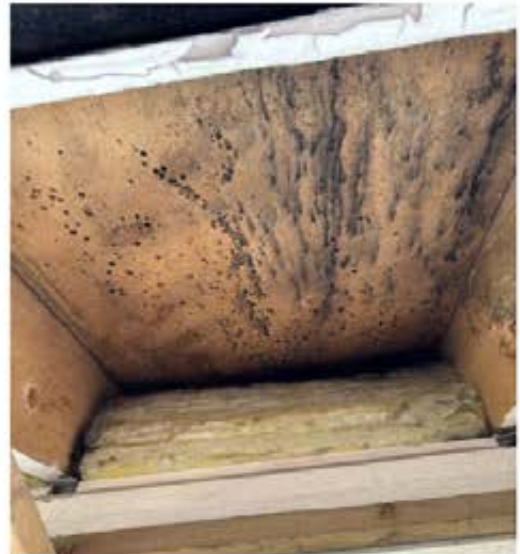
Undertak med svertesopp og skjolder
