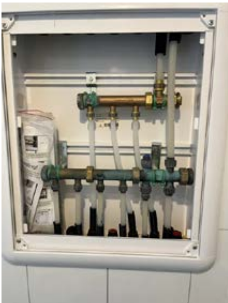
Manglende kursmerking og irr på fordelerstokk
