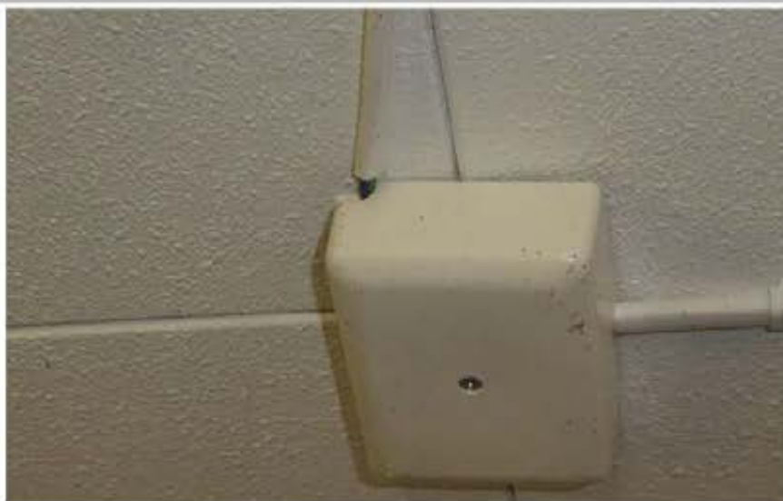
Takboks i stue med tilkoblet lampeledning.
