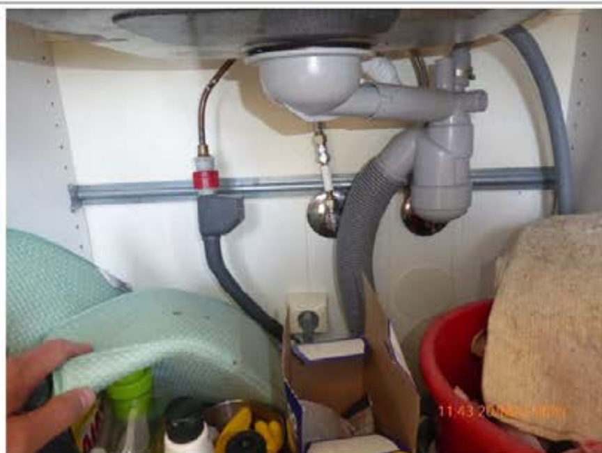
Ingen synlig vannstopper montert i kjøkkenbenken.
