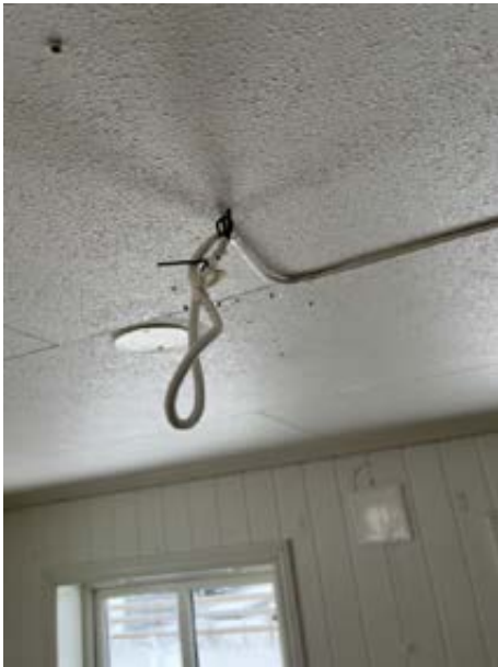
Uisolerte ledninger i tak 1.etasje
