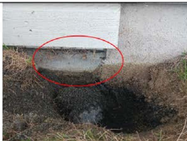
Kantstøp til originalt garasjegulv, nedkant av portåpning dekket med trekonstruksjon.
