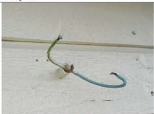
Strømførende kabler uten sikring
