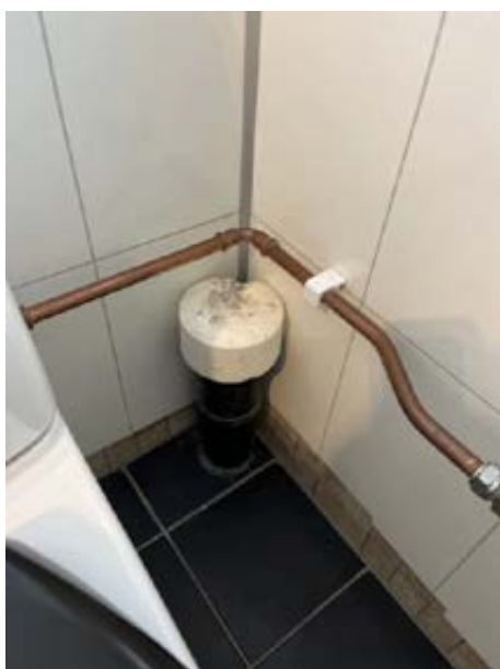
Lufting på avløpssystem
