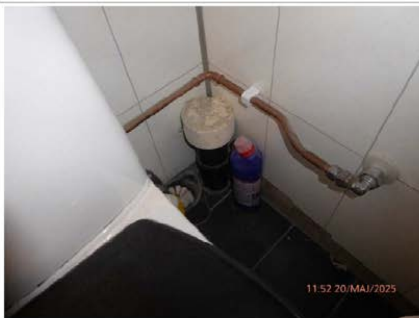
Durgo-ventil plassert i hjørne ved toalett på bad.
