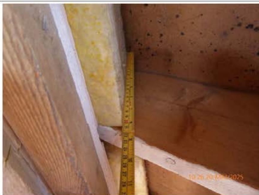
Glava med isolasjonstykkelse 2x100 mm. Vindsperre over isolasjon er ikke montert.
