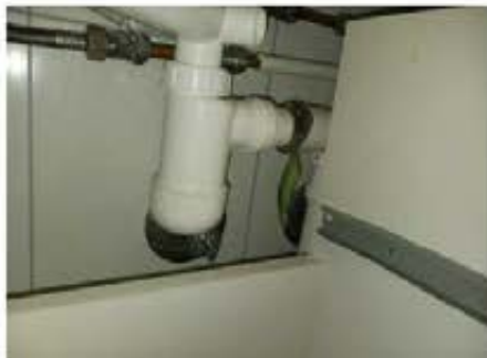
Lekkasje ved rørskjøter og vannlås.
