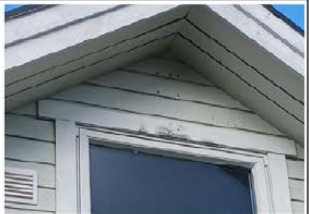
Klaffventil etablert av hjemmelshaver. Hulltaking i gavlspliss av eldre dato.
