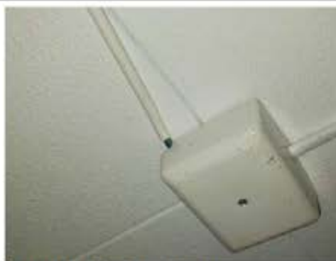
Lampett-ledning i fast installasjon
