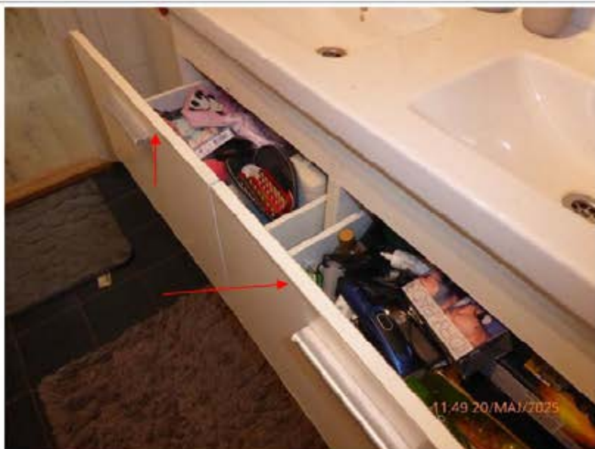
Svelleskader i topp av skuffefronter.
