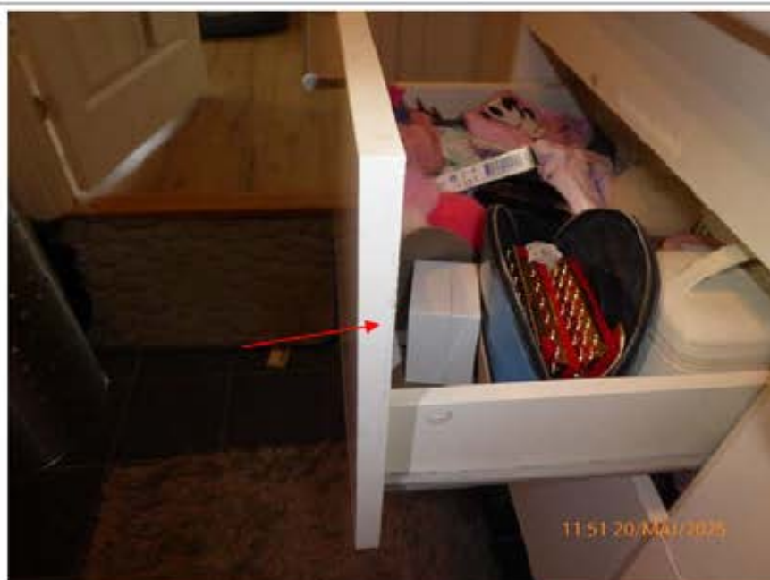
Rennemerker på siden av skuffefront etter vannsøl.
