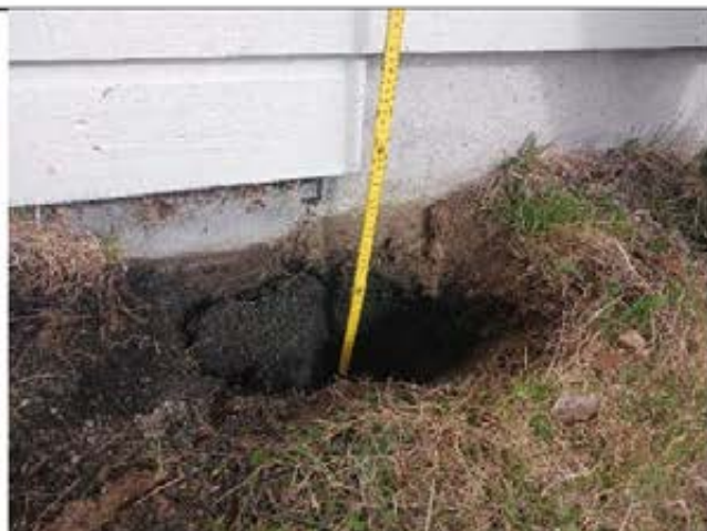
Ingen påvist markisolasjon under terreng
