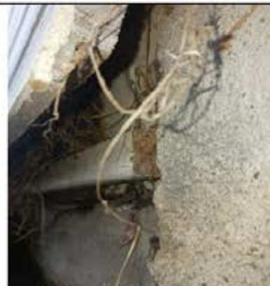
Ingen etablert sokkel ved tidligere garasjeinnkjøring. Kledning med mangelfull innfesting. Vindsperre fremstår uten klelekt.
