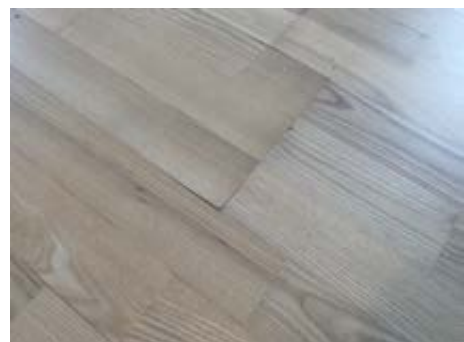
Liten skade i parkettgulv i stuen like ved ildsted. Kun av estetisk karakter.
