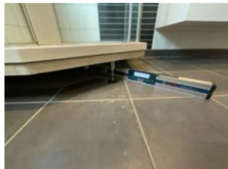
5 mm fall per meter lokalt ved sluken under dusjkabinett.
