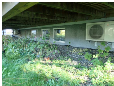
Grunnmurs papp og singel mot grunnmuren.
