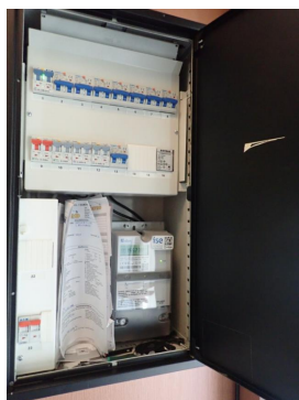
Elskap med 13 kurser over automatsikringer.
