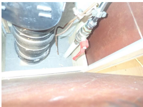
Stoppekran og stakeluke innebygget i kasse.
