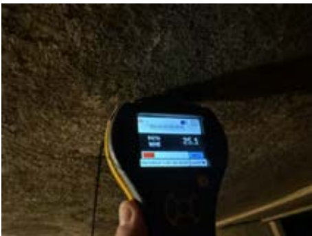
Forhøyede fuktverdier ble registrert.
