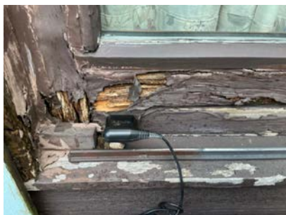
Fukt/råteskade på skyvedør. Bytte av dør må påregnes.
