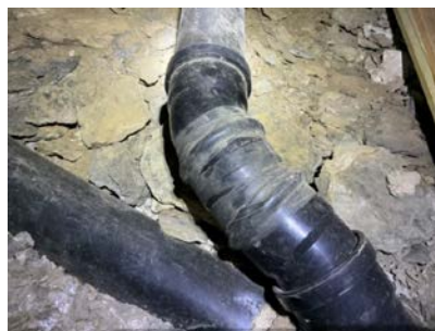
Avløps-rør er tapet over i skjøt.
