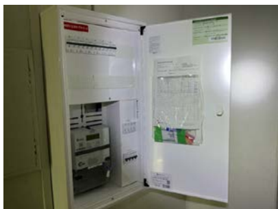
Sikringsskap står i gang 1 etasje.
