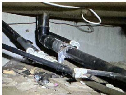
Avløps-rør er tapet over i skjøt.
