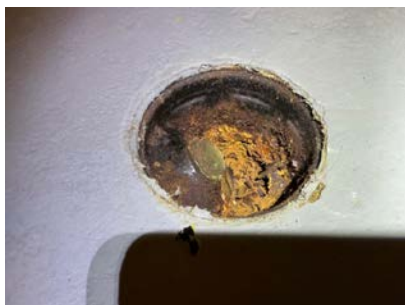
Sluk i bod med støpejern.
