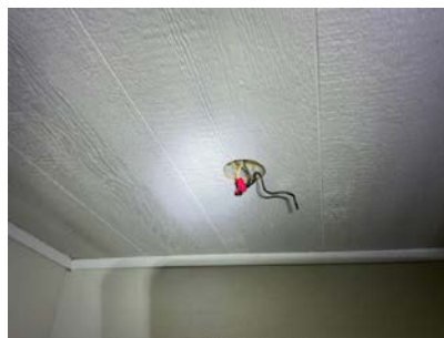
Deksel på takboks er ikke montert.
