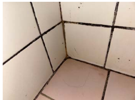
Svertesopp i fuger.
