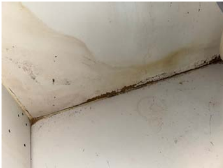
Gammel fuktskade i skap.
