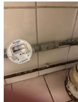
Stoppekran med vannmåler til varmt vann.
