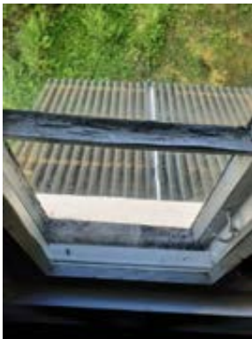
Fuktskader på vindu innvendig
