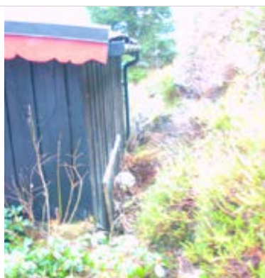
Vegetasjon helt inn til bordkledning
