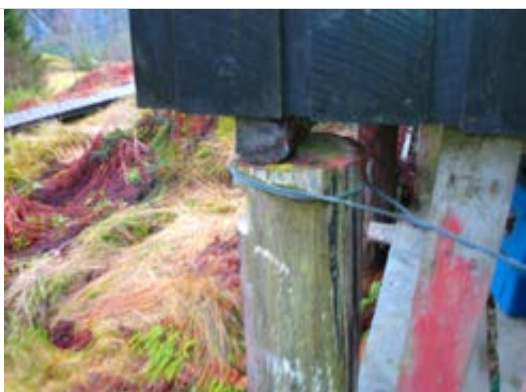
Stubbgulv og isolasjon har falle ned,
