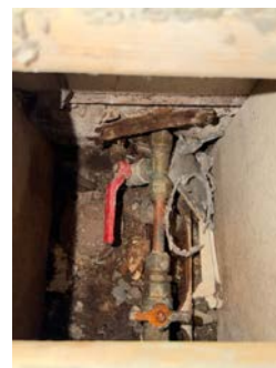
Stoppekran er plassert i gulv på bad i underetasjen.
