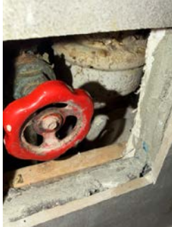
Stoppekran er plassert i vegg på bad i underetasjen.
