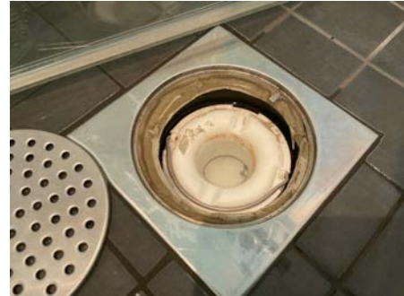
Sluk, synlig membran klemt korrekt under klemring.
