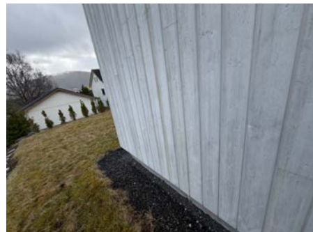
Fasaden har behov for maling/beis.
