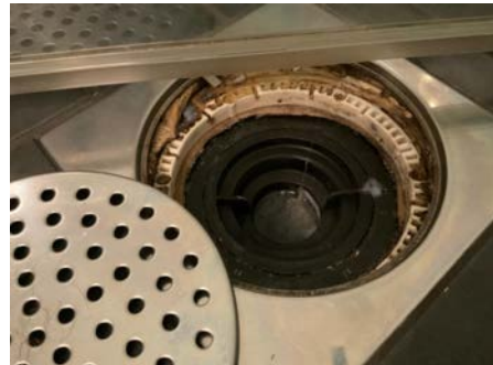
Sluk, synlig membran klemt korrekt under klemring.
