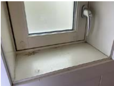
Fukt-merker i vindu.
