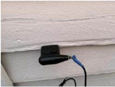
Fukt/råte-skade på ytterkledning.
