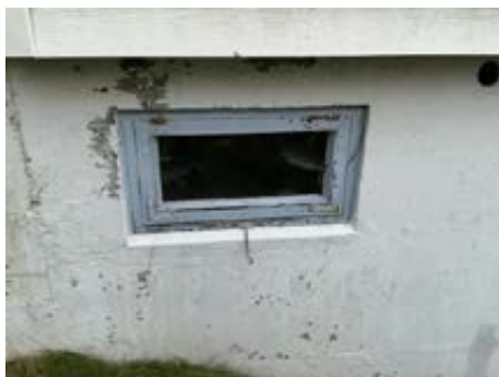
Fukt/råteskade på vindu til utvendig bod.
