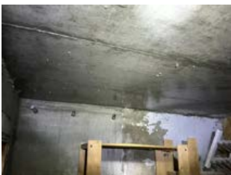
Vanndråper vann/fukt i tak på bod under balkong.
