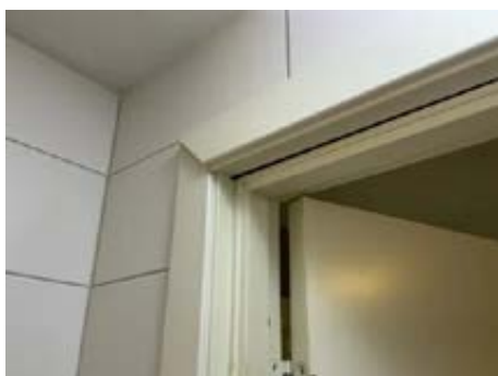
Avslutning med dør-list er ikke fagmessig utført.
