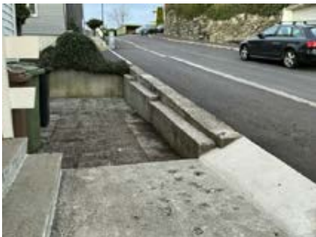
Støttemur mot gate. Rekkverk er ikke etablert.
