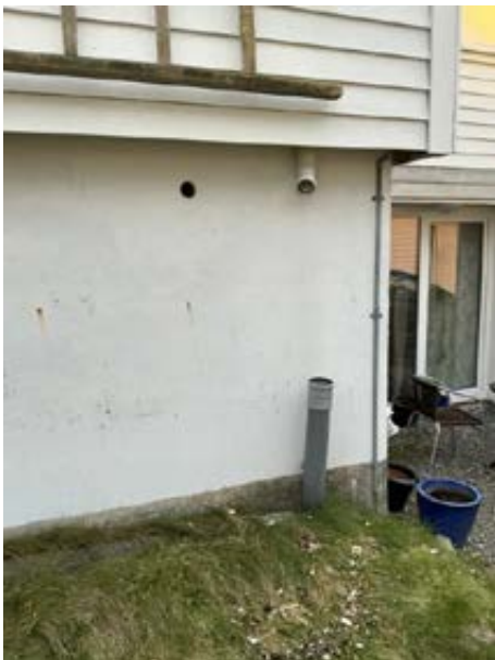
Nedløp er ikke ferdigstilt.
