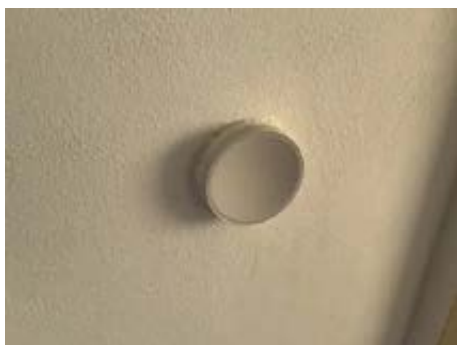
Røk-løp i stue er tettet med plastdeksel.
