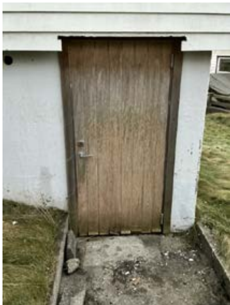
Fukt/råteskade på dør til utvendig bod.
