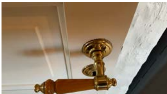
Slitasje etter løst skilt/vrider
