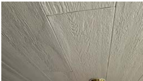
Himling i stue, skade etter fukt. jf. kontaktperson
