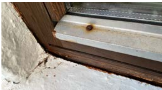
Korrosjon, glippe mellom murpuss og vindu.
