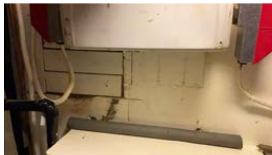
Synlig brennbar isolasjon
