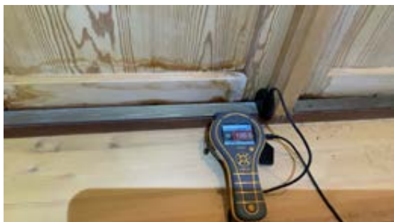
Høyt fuktnivå altandør, dør kan ikke åpnes.
