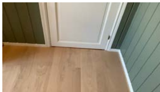
Dør tar i gulv
