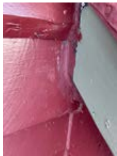
Fuging mellom kledningsbord og takutstikk
