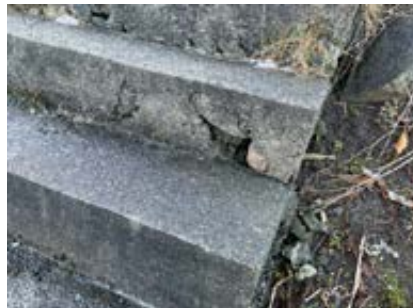
Sprekker /sparestein synlig
