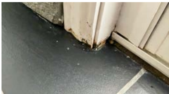
Trekker vann inn ved dør. Fuktig og mjukt trevirke
