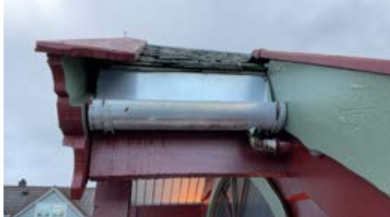
Drypper fra overgang til plastrør
