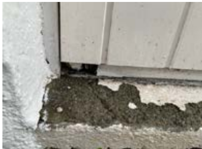
Råte dør til bod , dør mangler beslag under
