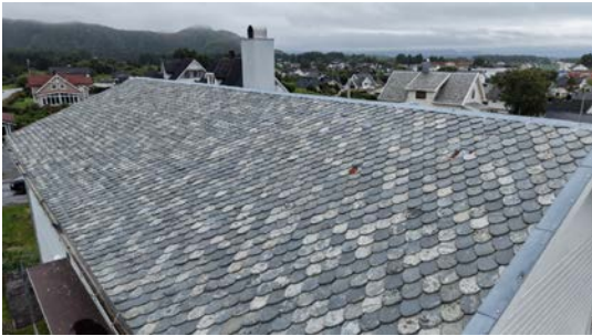
Enkelte skifersteiner mangler og er erstattet med beslag
