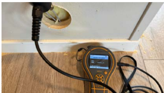
Fuktsøk i tilstøtende vegg
