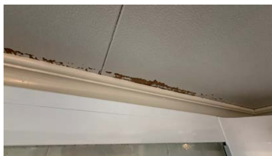
Noe merker i himlingen over dusjen
