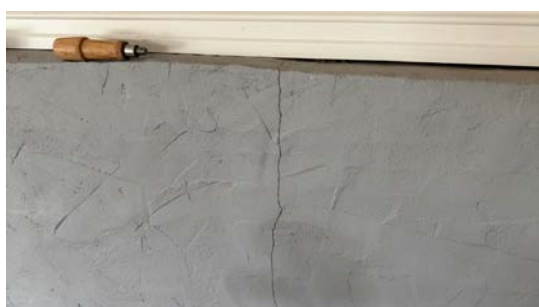
Sprekker i overflater på brannmuren bak peisen
