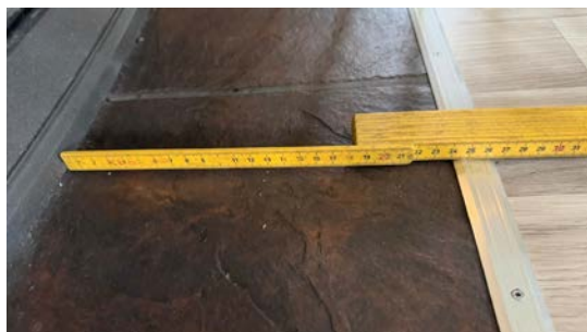
Avstanden er mindre enn 30 cm til brennbart materiale
