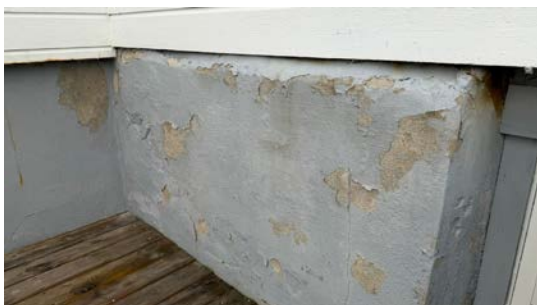
Slitasje i overflaten på grunnmuren
