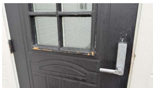
Slitasje i overflaten på ytterdøren
