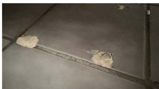
Det er fuget i gulvet ved toalettet. Ukjent årsak
