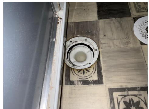
Sluk under dusjkabinett
