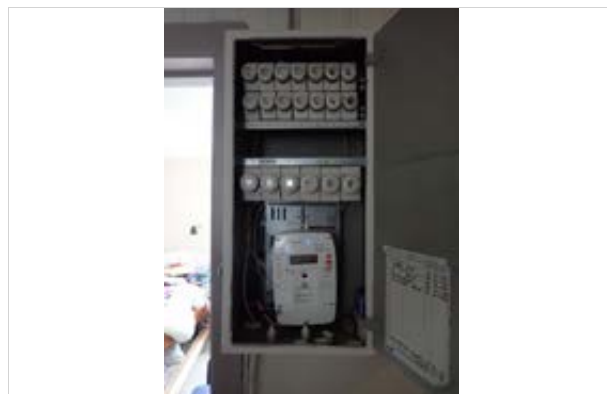
El-skap med krussikringer
