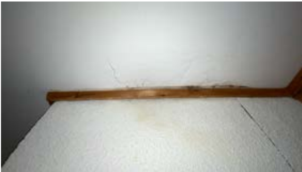
Skader etter tidligere vannskade fra tak.
