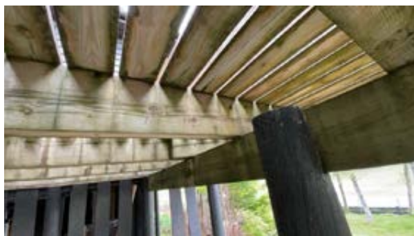
Noe fuktmerker som normalt ved en åpen konstruksjon utvendig.
