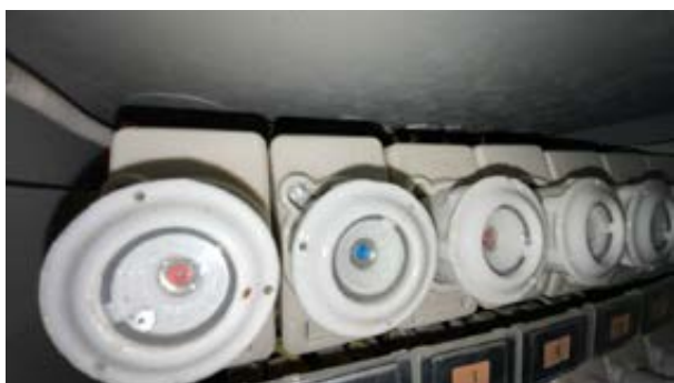
Åpninger i øvre del av skap, må tettes.
