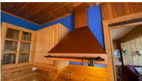
Ventilator over komfyr.
