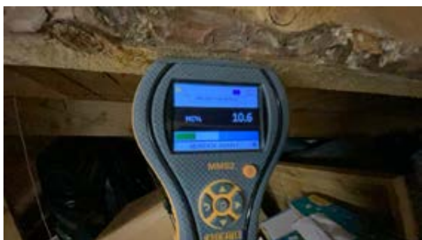
Det ble målt 10,6 vekt% fukt i takkonstruksjonen ved dagens befaring.
