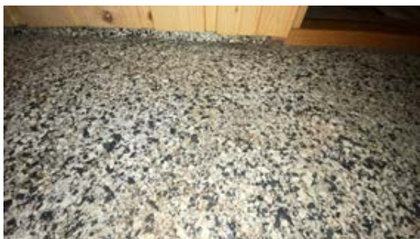
Epoxybelegg uten tilfredsstillende oppkant ved terskel.
