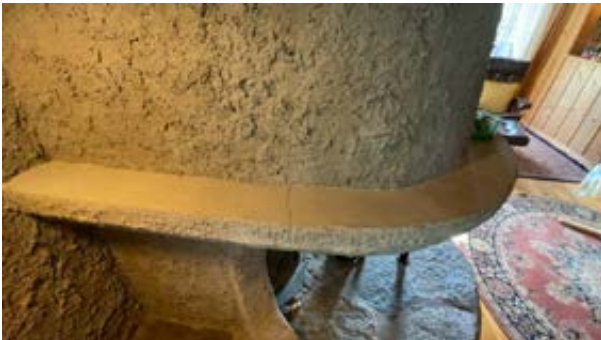
Riss/sprekker i murkonstruksjon
