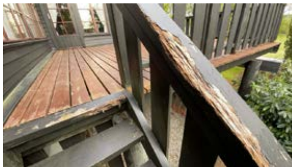
Betydelige råteskader i trapp/rekkverk.
