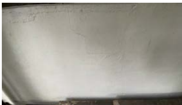
Slitasje på overflatebehandling.
