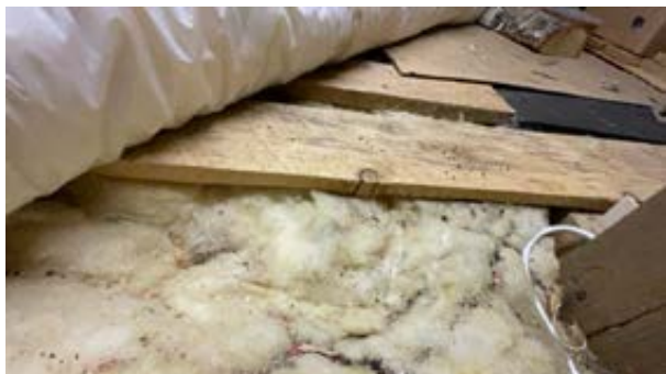
Tegn på skadedyr (mus) på kaldloft.
