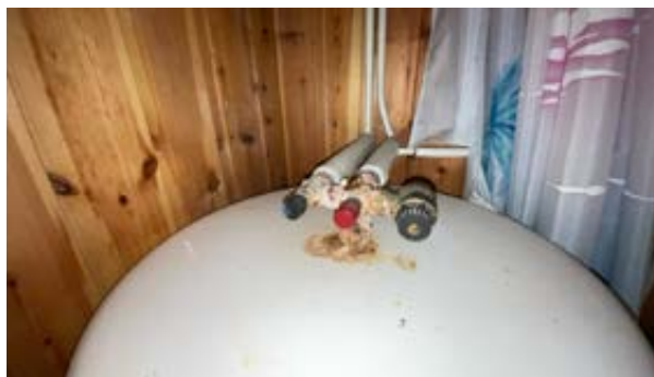
Korrosjon på messingrør topp bereder.
