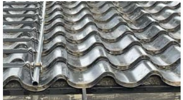
Slitasje på overflatebehandling
