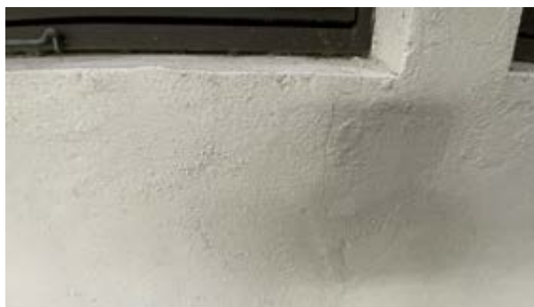
Mindre riss i puss.
