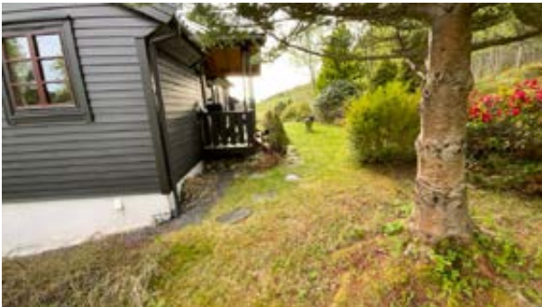
SVAKT TERRENGFALL MOT BYGNINGSMASSEN PÅ OVERSIDEN MOT FJELLET.
