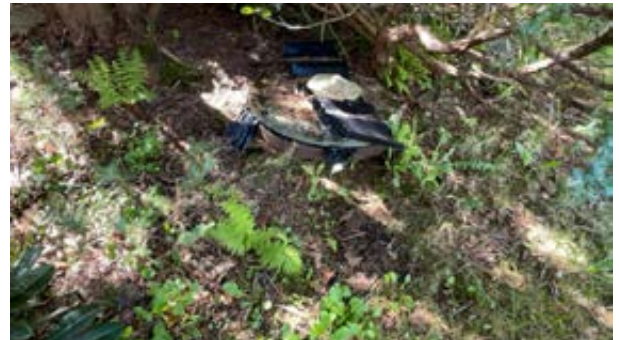
LOKK TIL SEPTIKKTANK, IKKE DOKUMENTERT/KONTROLLERT.
