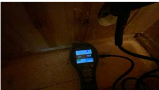
Det ble målt 10,8 vekt% fukt i svill bak badekar.
