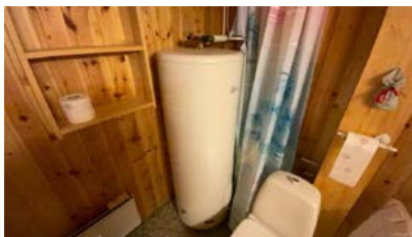
Varmtvannsbereder i bad kjeller.
