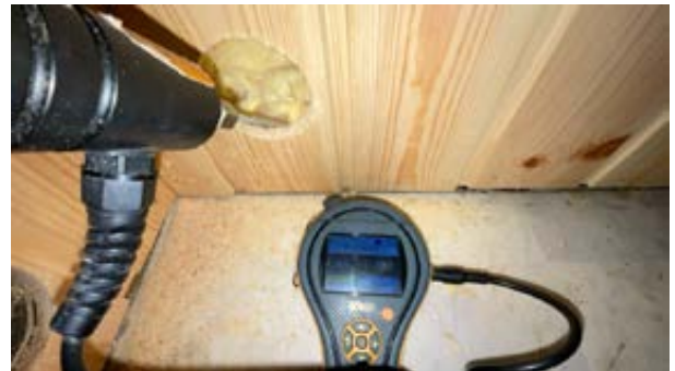
Det ble målt 19,7 vekt% fukt i bunnsvill.
