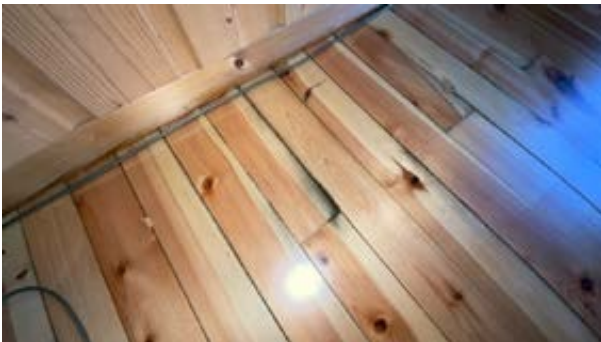
Skade etter vannskade på kjøkken tidligere.
