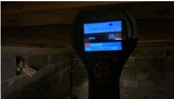
Det ble målt 26,2 vekt% fukt i bjelkekonstruksjonen.
