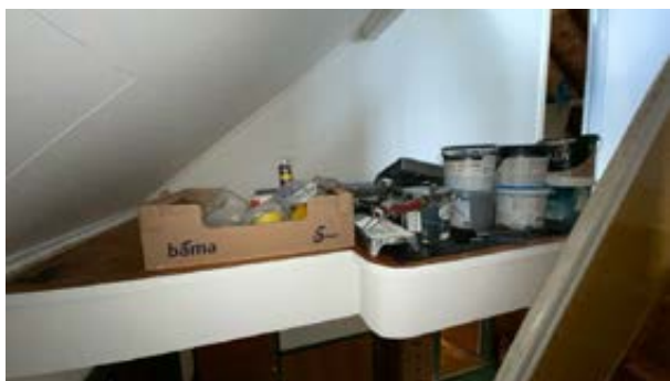
Stedvis manglende rekkverk på loft.
