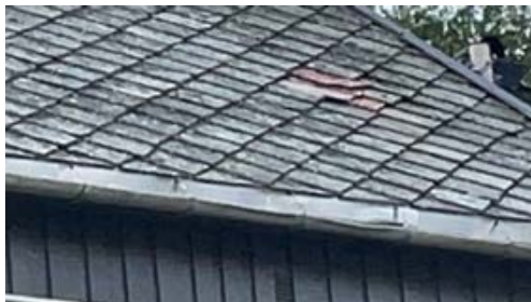
Midlertidige utbedringer grunnet lekkasjer.
