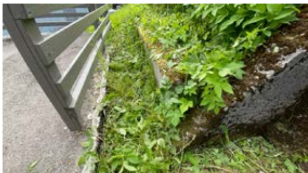
Mur bak garasje er presset ut grunnet jordtrykk/tele.
