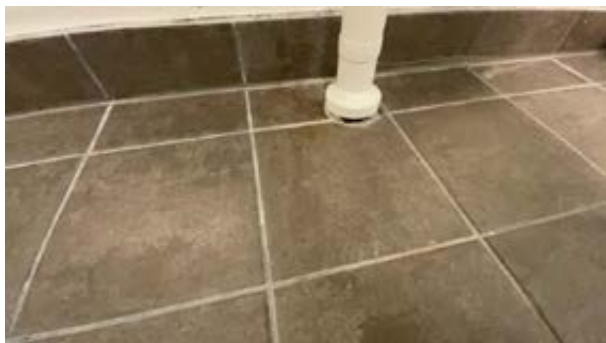
Ikke synlig rørmansjett ved rørgjennomføring i gulv.
