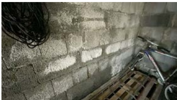
Fuktvandring i kjellervegg mot terreng i garasje.
