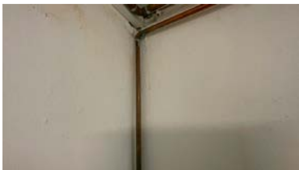
Manglende veggfester på kobberør.
