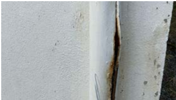
Korrosjon/lekkasje på nedløpsrør.
