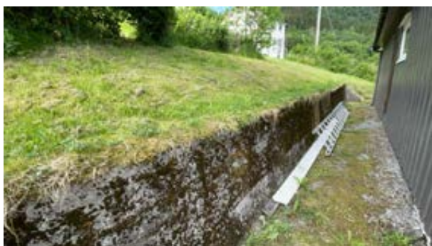
Manglende sikring ved gjerde/beplantning.
