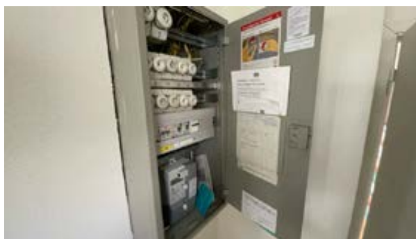
Sikringskap på loft.
