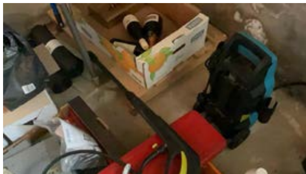
Fuktvandring i kjellergulv i bod.
