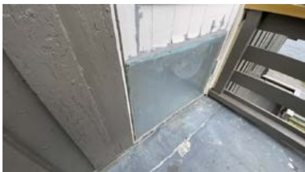
Råteskader i nedre del/brystning.
