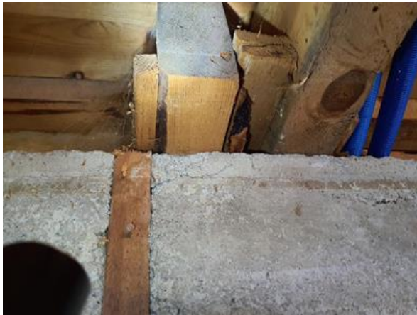
Endestubbe på bjelkelag. Her var noe flere borehull
