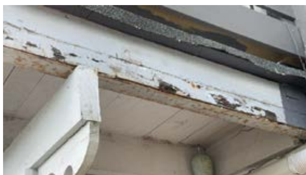
Råteskader i altan mot øst.
