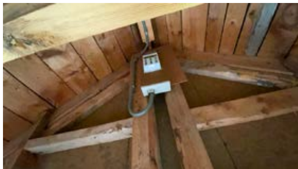
Hovedsikring på gavlvegg loft.
