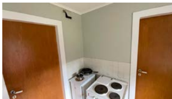
Ingen avtrekk fra kokesonen.
