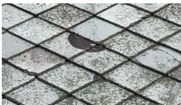
Midlertidige utbedringer grunnet lekkasjer.
