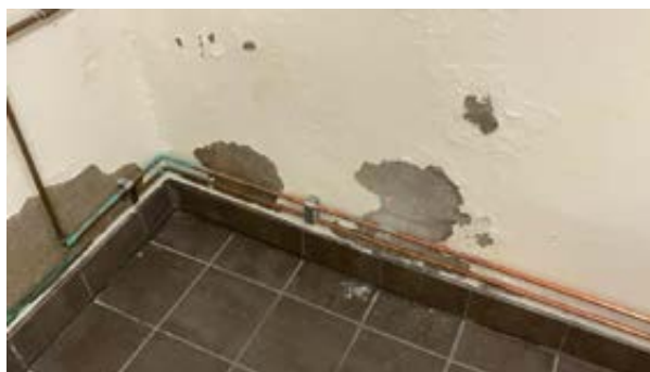
Fuktvandring i kjellervegg mot terreng i vaskerom.
