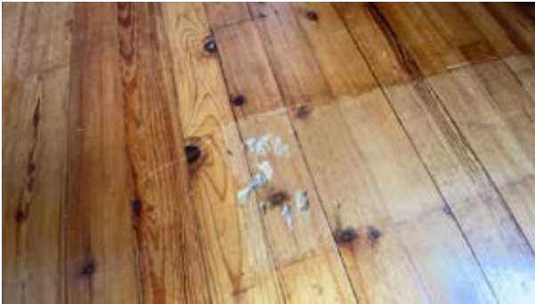
Skader på gulv.
