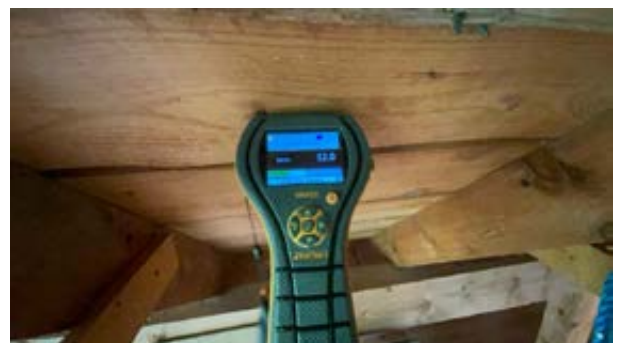
Det ble målt 11,7 vekt% ved en tidligere lekkasje.
