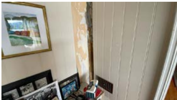
Ikke synlig pipevanger på fire sider.
