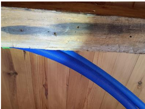
Borehull i bjelke. ( de store hullene er fra spiker )
