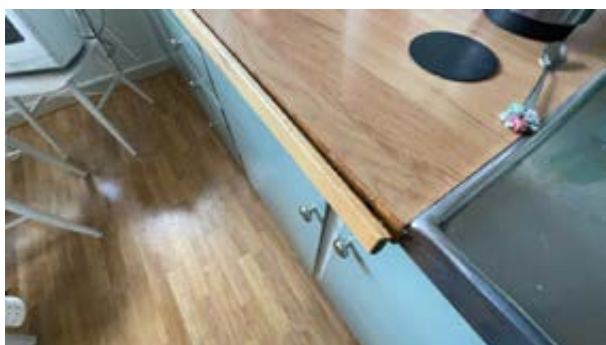
Skade på rontlist benkeplate.
