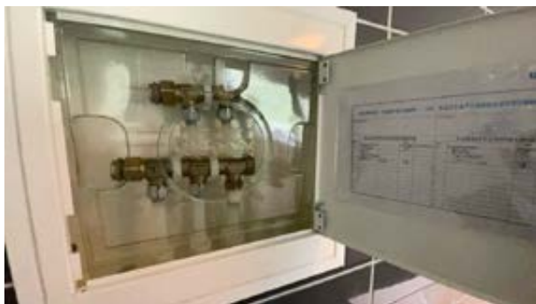
Rør i rør sentral.
