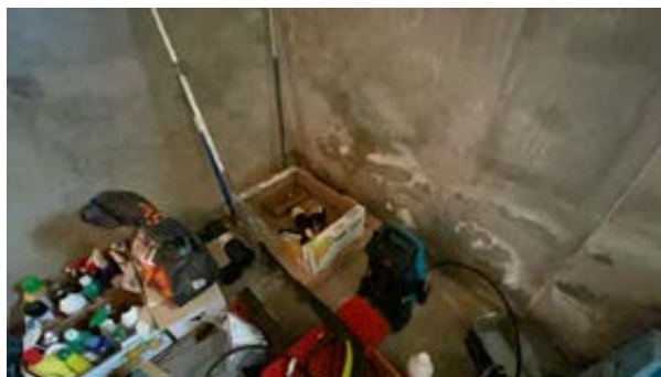
Fuktvandring i kjellervegg mot terreng i bod.
