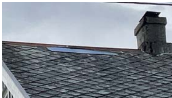
Midlertidige utbedringer grunnet lekkasjer.
