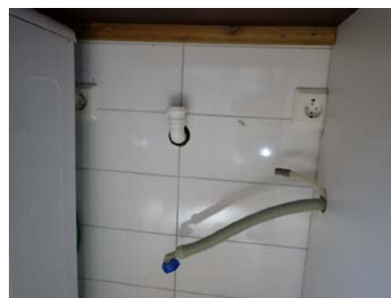
Ikke mansjett/tetting rundt rørgjenomføring
