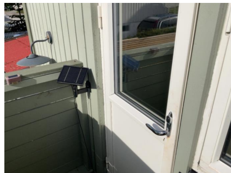
Balkongdør fra soverom 1. Etasje, med defekt låse/vriderfunksjon.
