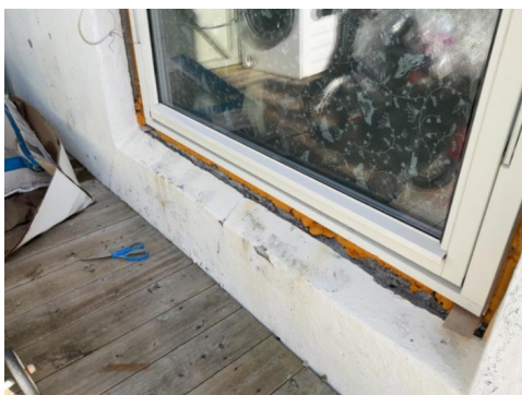
Manglende vannbrett/tetting på vinduer i kjeller.
