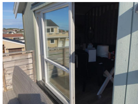
Balkongskyvedør mot vest i 2. Etasje, med løst innvendig håndtak.
