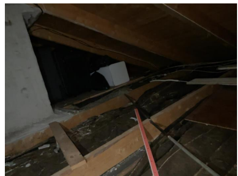
Ikke tilfredstillende brannvegg/skillemot kaldloft.
