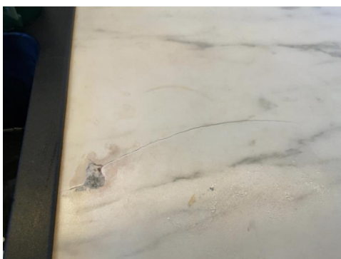
Skader på benkeplate.
