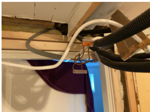
Manglende komplettering av kasse i tak (kjeller).
