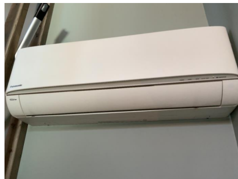
Innvendig luft til luft varmepumpe.
