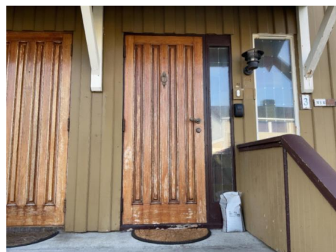
Hovedinngangsdør i teak med sidefelt i glass. Døren har behov for overflatebehandling.
