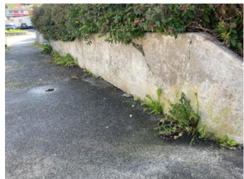
Sprekker i mur mot kommunal vei.
