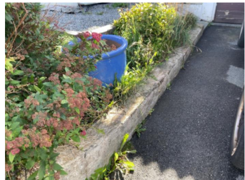
Mindre sprekker i mur.
