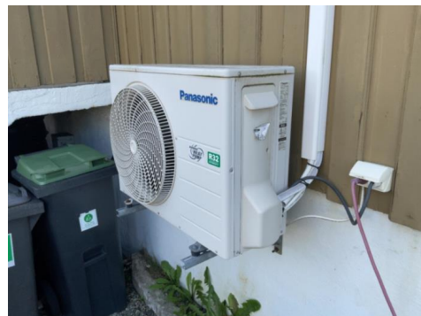
Utvendig enhet for luft til luft varmepumpe på nordvegg.
