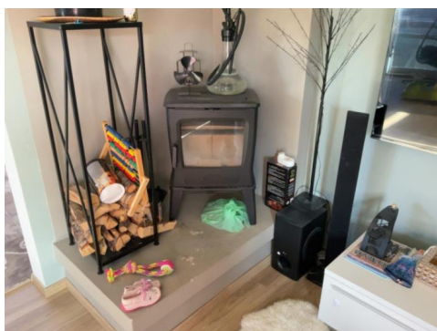
Dovre vedovn i stue/kjøkken 2. Etasje.
