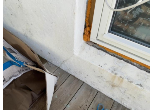
Mindre riss/sprekker i grunnmr.
