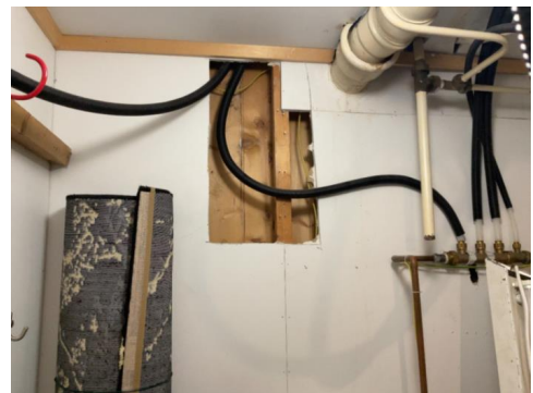
Ikke tilfredstillende brannvegg mot nabo, åpent bindingsverk uten gipsplater.
