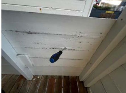
Eksempel på råteskader.
