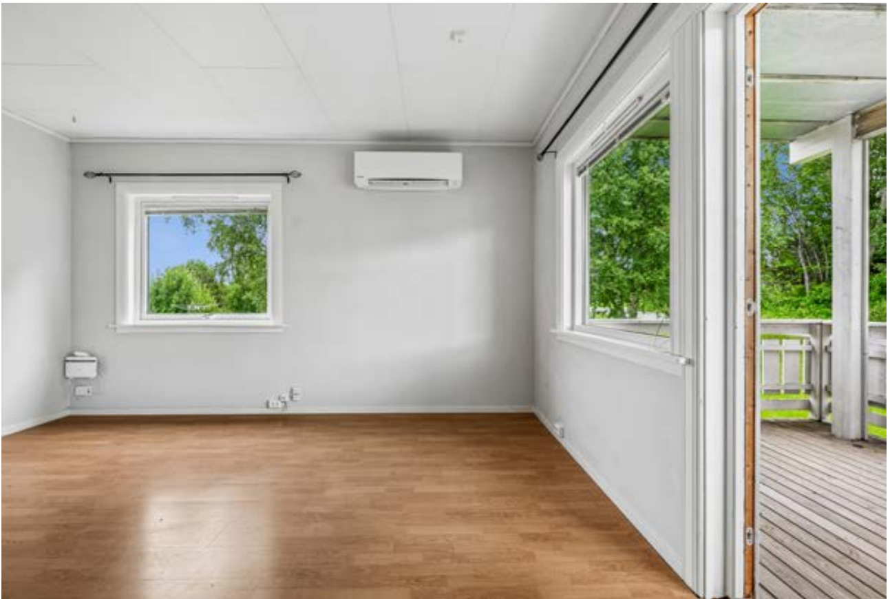
Stuedel- varmepumpe oppe i hjørnet
